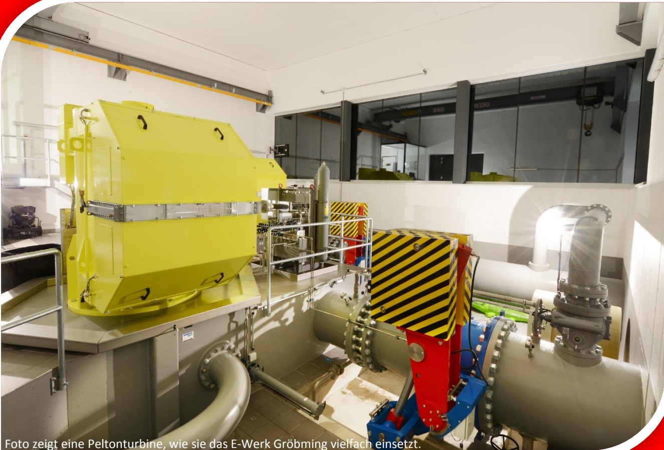
Foto zeigt eine Pelton-turbine, wie sie das E-Werk Gröbming vielfach einsetzt.
