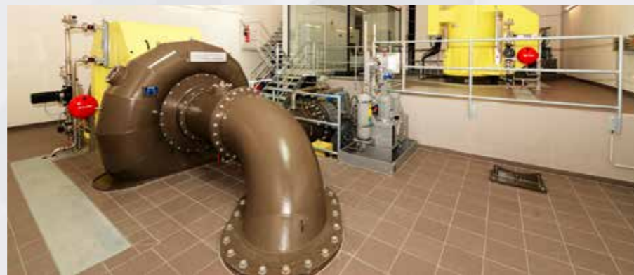
Beispiel einer Francisturbine im Kraftwerk Großsölkbach-Mössna.
