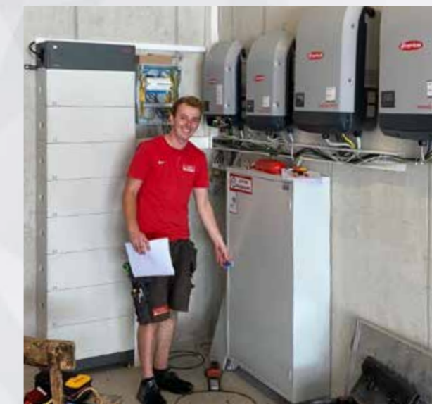
Marcel Pichler vor einem BYD 22 kWh Speicher (links)
