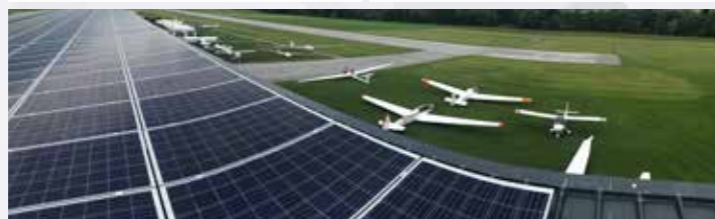
Flughangar Niederöblarn, 550 kWp
