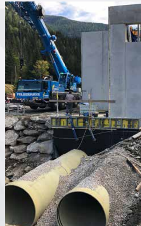
Die beiden Unterwasserkanäle im Krafthaus
