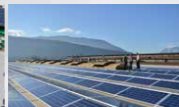
MFL Liezen, 700 kWp
