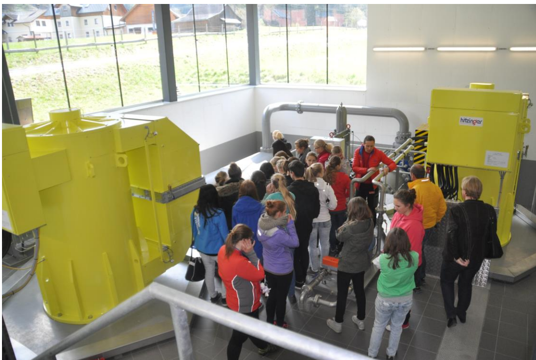
Bildtext: Die Fachschule Gröbming zu Besuch im Wasserkraftwerk St. Nikolai. Fotocredit: E-Werk, honorarfrei.
