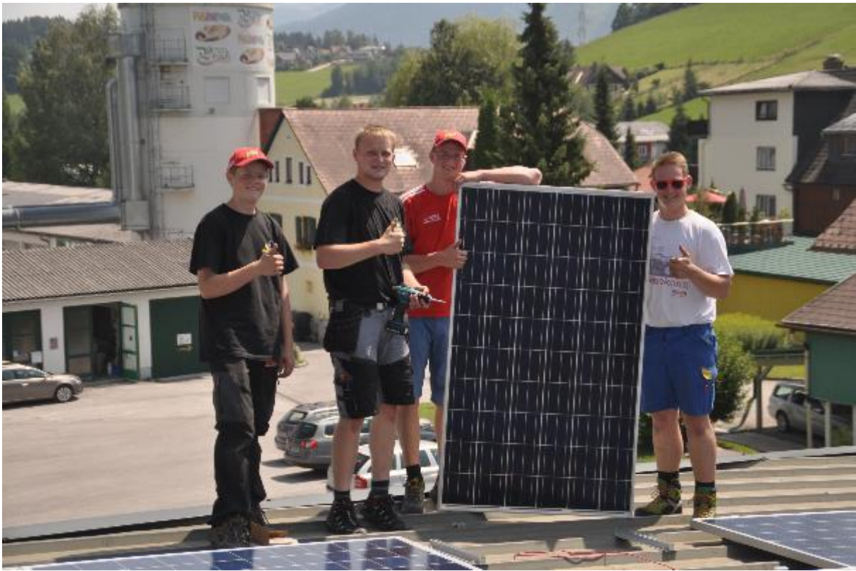
Bildtext: Das ambitionierte PV-Team des E-Werkes Gröbming wird heuer etliche tausend Quadratmeter Photovoltaik-Module in der Region installieren. Foto: E-Werk. Abdruck honorarfrei.
